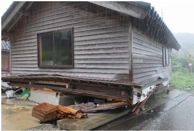
一階が大きく潰れた、太鼓を保管していた場所
